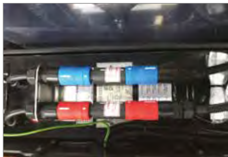
Typická batéria Ex e (Dbajte na špecifikácie a certifikačný štítok na veku)
